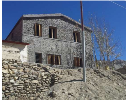
[Bau der zwei neuen Klassenräume (1. Etage) und des neuen Lagerraum (im Erdgeschoss)]
